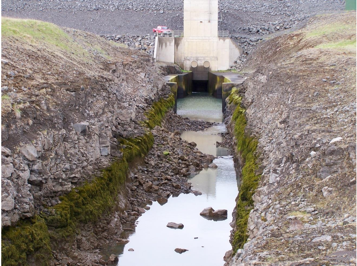
Mynd 29 Kolkuskurður. Viðhaldsstopp.
